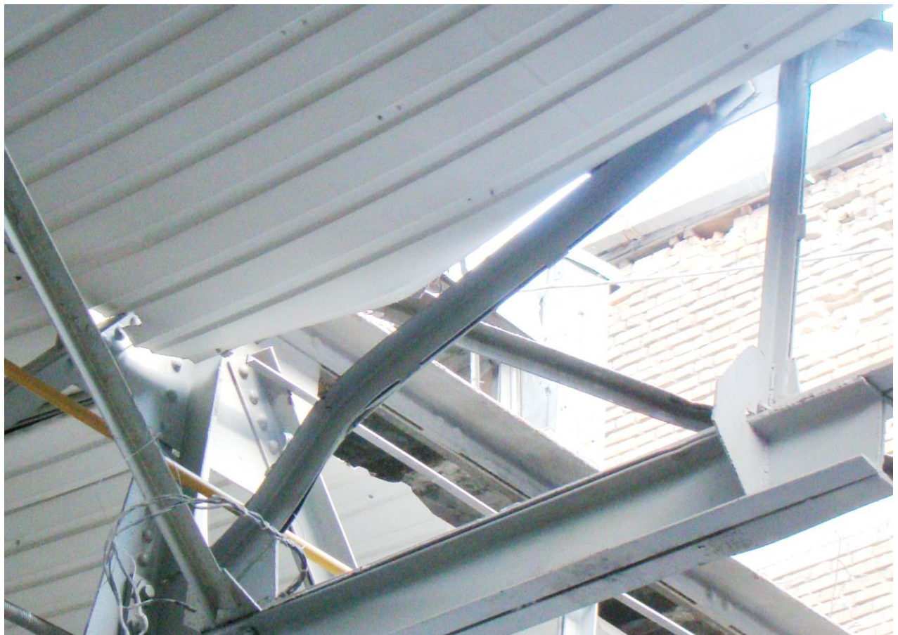
Мал. П.2.40. Вигин (зі стрілкою 80÷100мм на довжині елемента – наверх) опорного розкосу (зі сторони ряду Г) кроквяної ферми в рядах Г-Д по осі 2
