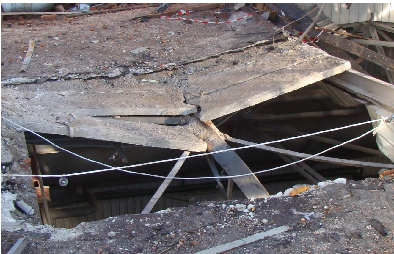
Мал. П.2.48. Руйнування плит покриття (по верхнім поясам кроквяних ферм) в рядах Г-Д та осях 1-2
