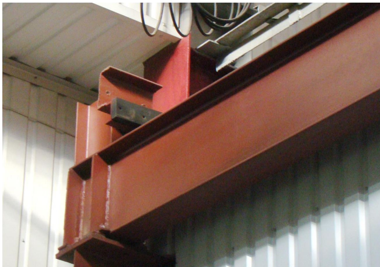
Мал. П.2.16. Вид на конструкції упору (на підкрановій балці) – в рядах Г-Д
