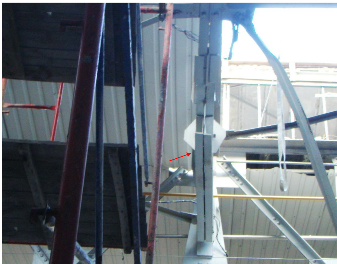
Мал. П.2.38. Вигин (зі стрілкою 40мм на довжині елемента – в стороні осі 3) нижнього поясу кроквяної ферми в рядах Г-Д по осі 2
