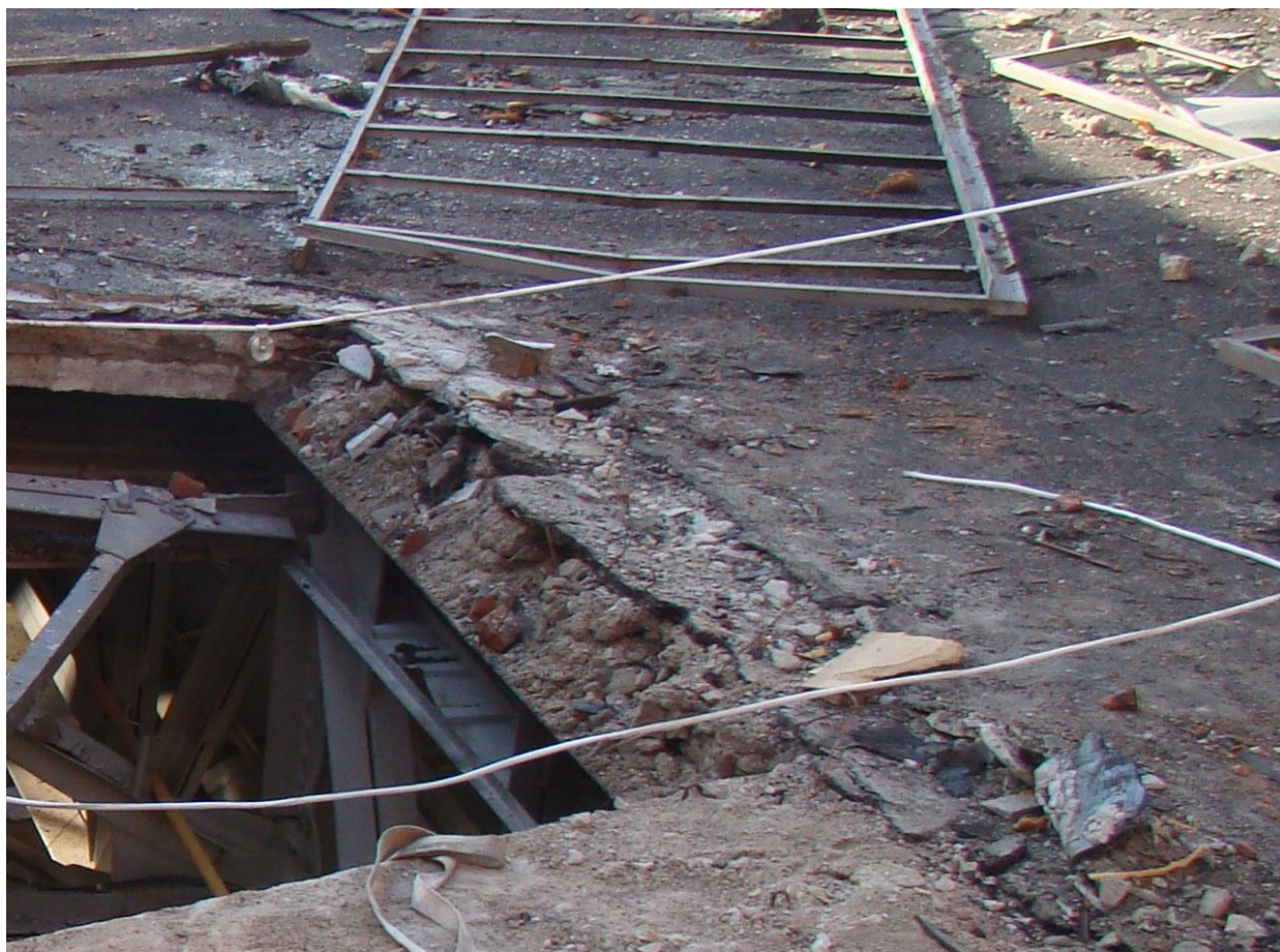
Мал. П.2.52. Сліди масових замочувань стяжки та засипки покрівлі (в осях 1-5 та рядах В-Г-Д)
