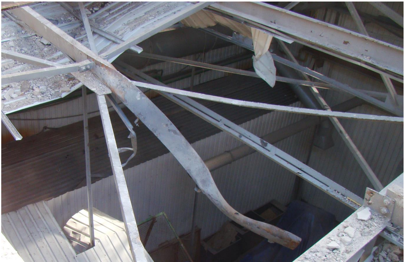
Мал. П.2.46. Руйнування прогону покрівлі (по верхнім поясам кроквяних ферм) - в рядах Г-Д та осях 1-2
