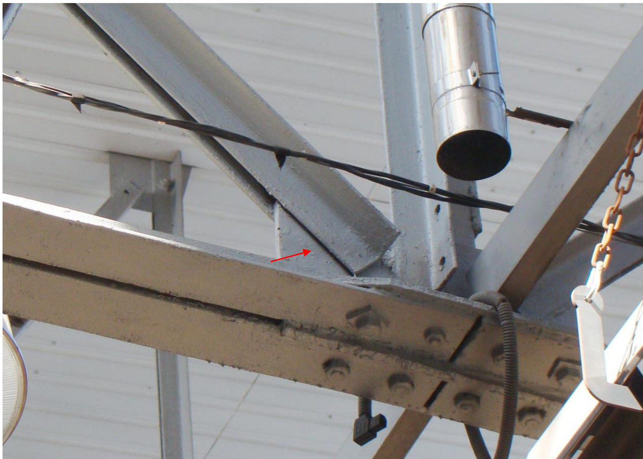
Мал. П.2.35. Відсутність зварного шва по перу кутика (зі сторони осі 4) розкошу кроквяної ферми в рядах В-Г по осі 3 (в місці кріплення до нижнього поясу)
