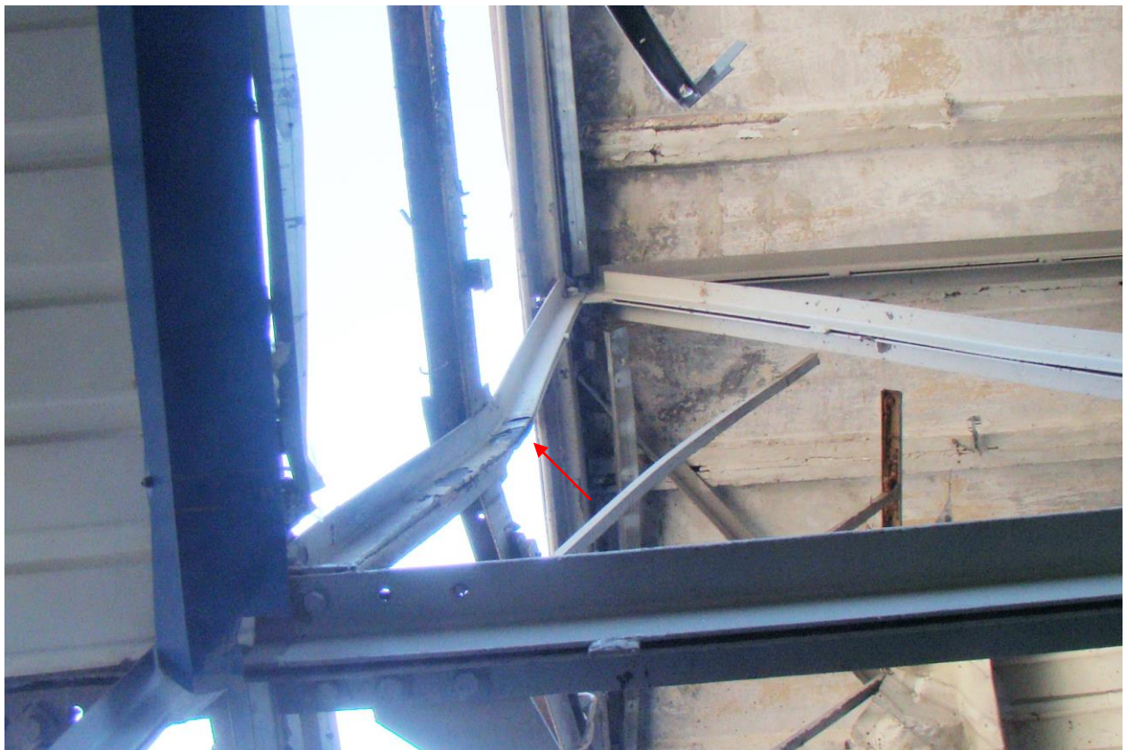
Мал. П.2.42. Вигин (зі стрілкою 140мм на довжині елемента – в сторону ряду Д) опорної стійки ферми ліхтаря в рядах Г-Д по осі 2
