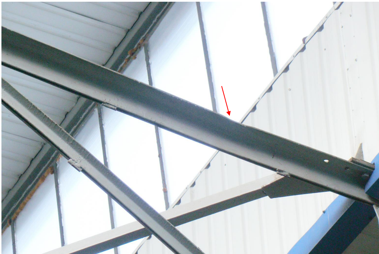
Мал. П.2.37. Вигин (зі стрілкою 25мм на довжині елемента – вниз) верхнього поясу кроквяної ферми в рядах Г-Д по осі 4
