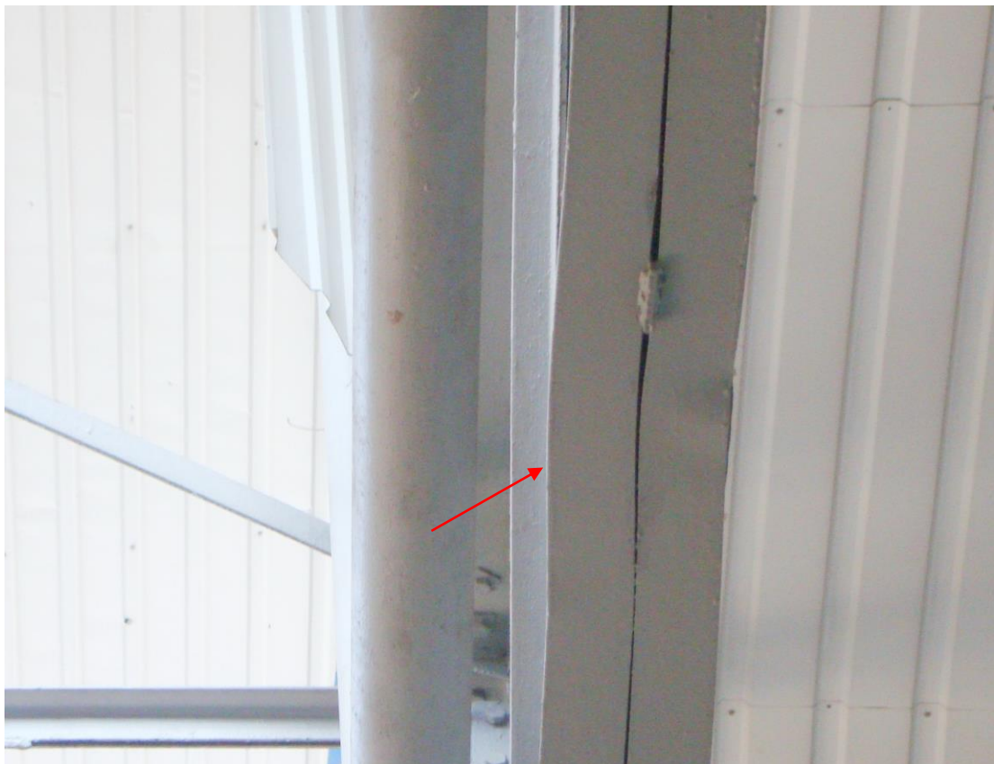
Мал. П.2.34. Вигин (зі стрілкою до 35мм на довжині 2.25м – в напрямку осі 2) нижнього поясу кроквяної ферми в рядах В-Г по осі 1
