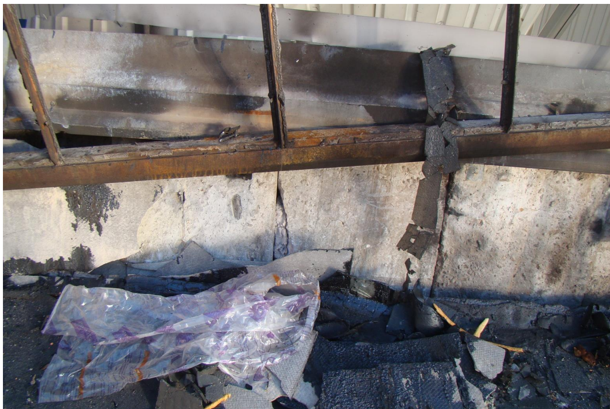
Мал. П.2.50. Руйнування та пошкодження плит бокового огородження ліхтарів (в осях 1-5 та рядах В-Г-Д)
