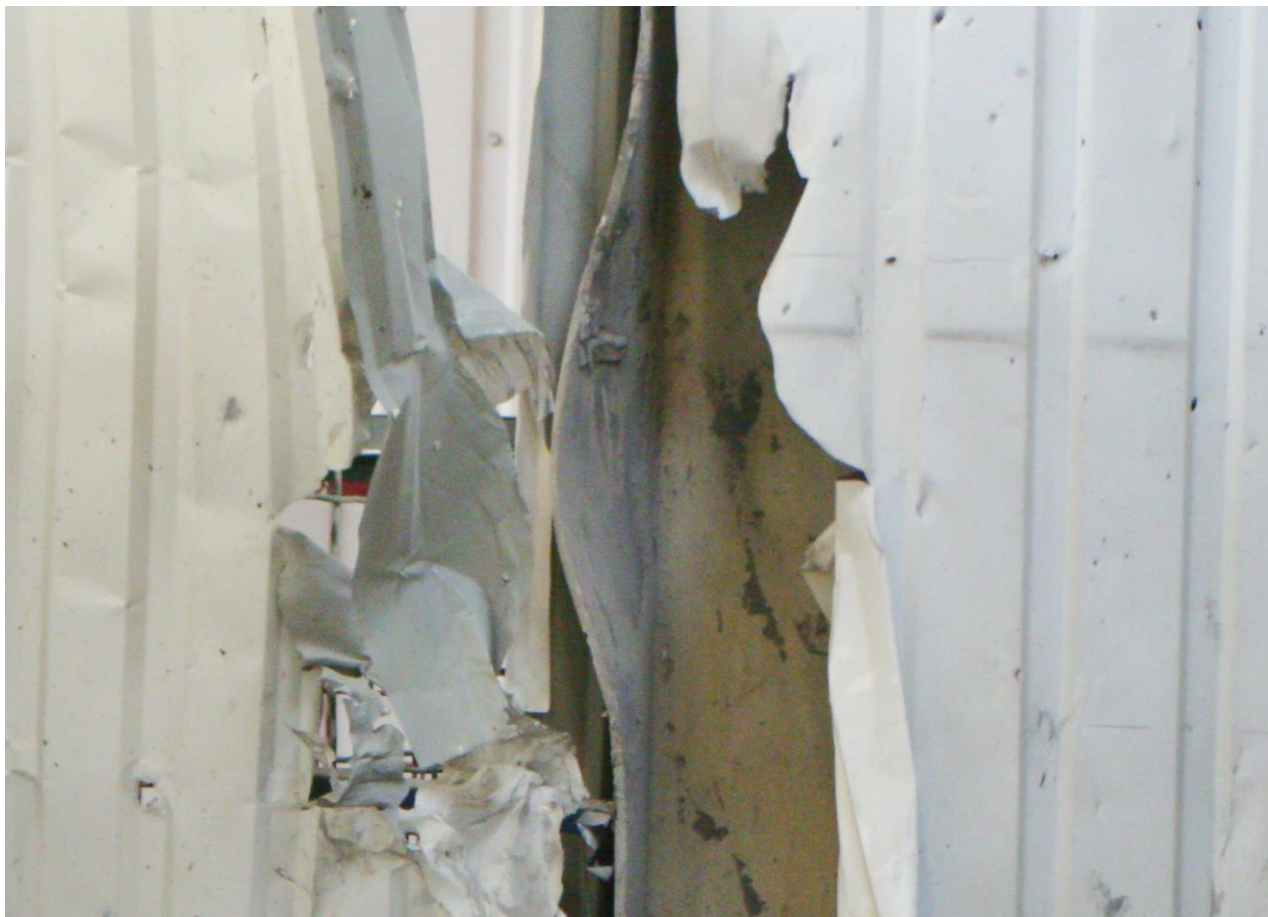
Мал. П.2.29. Місцева погнутість (зі стрілкою 80-90мм на довжині 600мм – в сторону ряду В) полки зварного двотавру колони ряду Г по осі 1 (на відм. +1.800)
